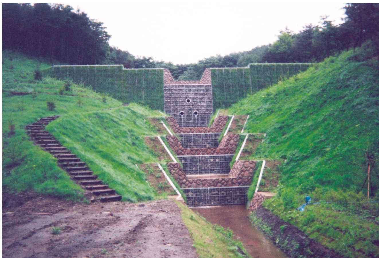
半年経過後 芝原沢2号砂防えん堤 平成10年〔福島県〕
