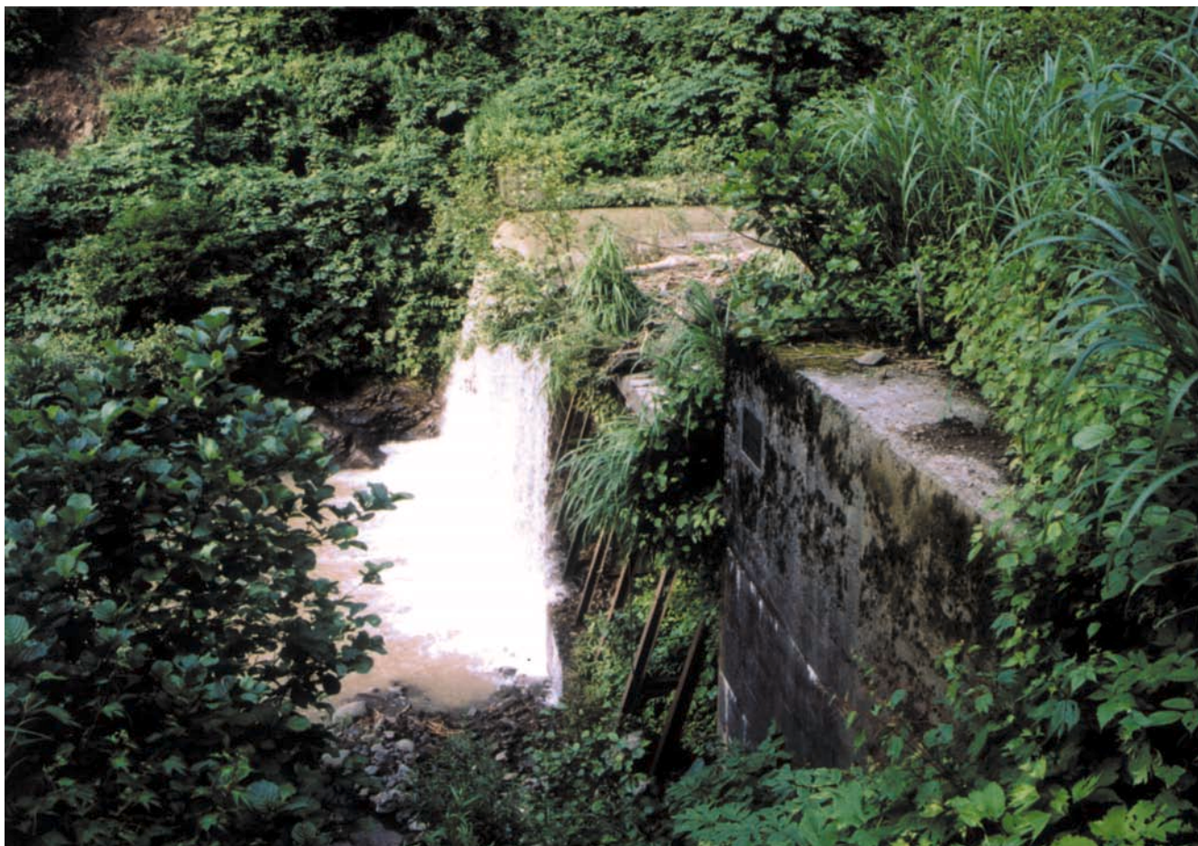
満砂になった鋼製スクリーンえん堤 昭和40年代後半[新潟県]
