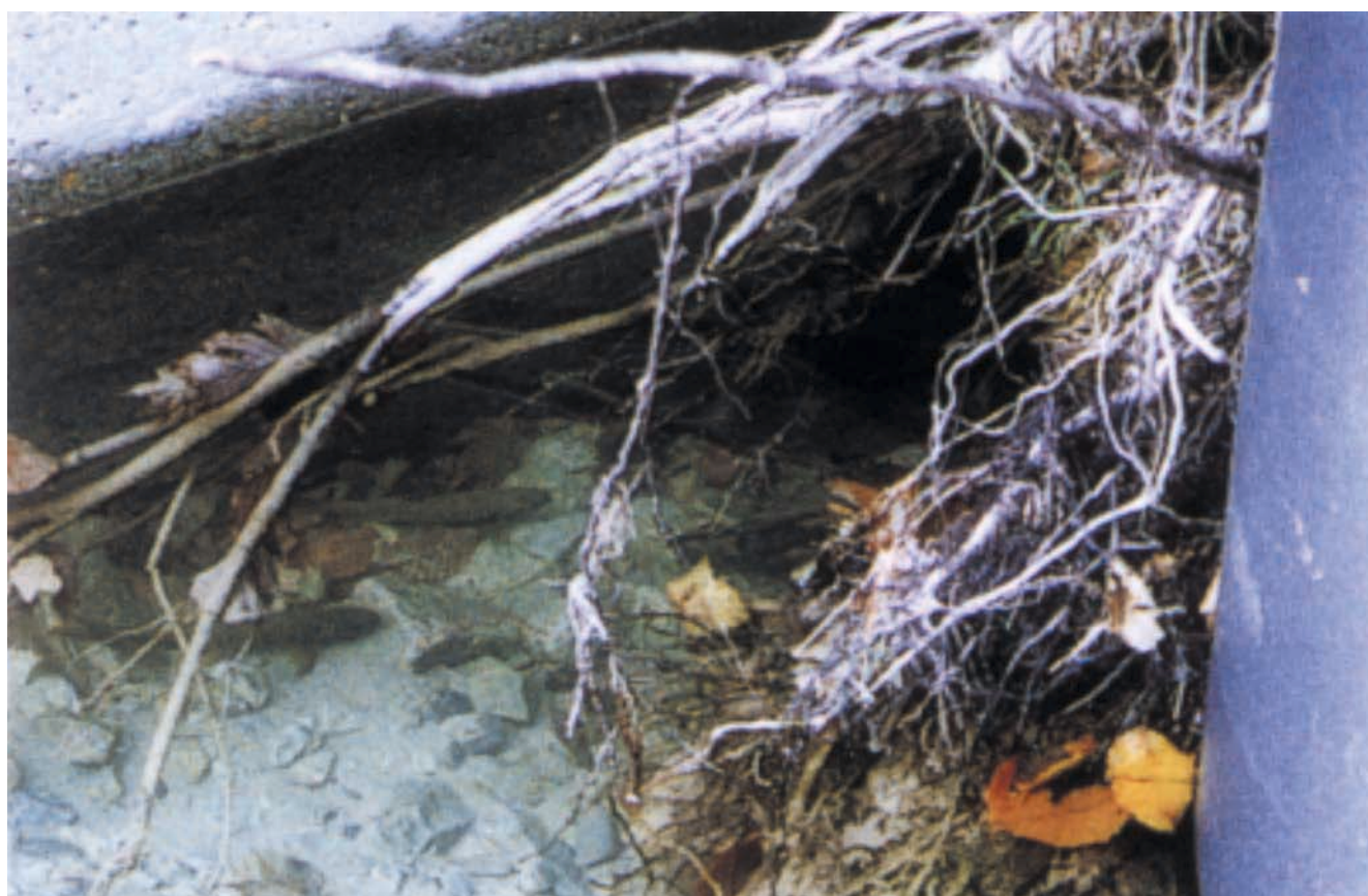
上の沢第4砂防えん堤 鋼製部高10.5m、全幅62m、鋼製部幅10m、水通し幅12m(121.4トン) 平成7年[飯豊山系砂防工事事務所]
