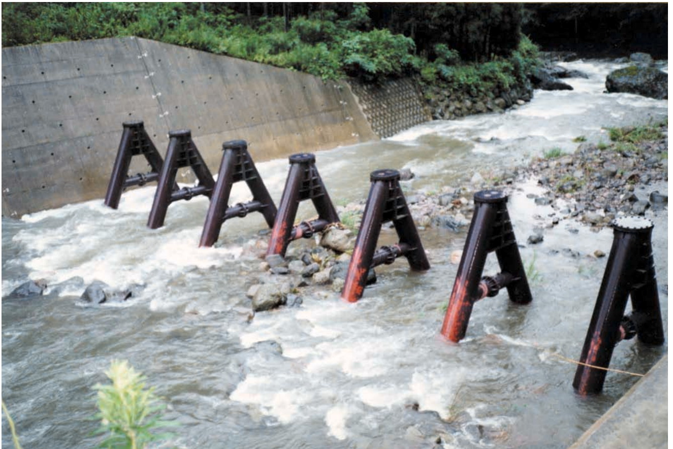
北里川 鋼製部の塗装面変色は礫等の捕捉、衝突による 鋼製部高4m 平成5年[ 熊本県 ]
