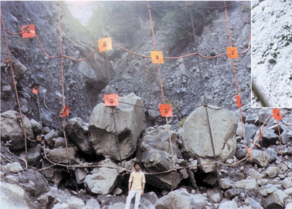
ワイヤーネット【松本砂防工事事務所】
